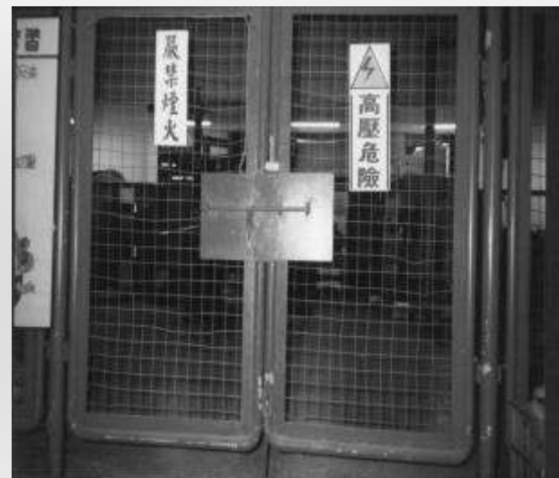
高壓試驗場以鐵網圍住並標示警告
