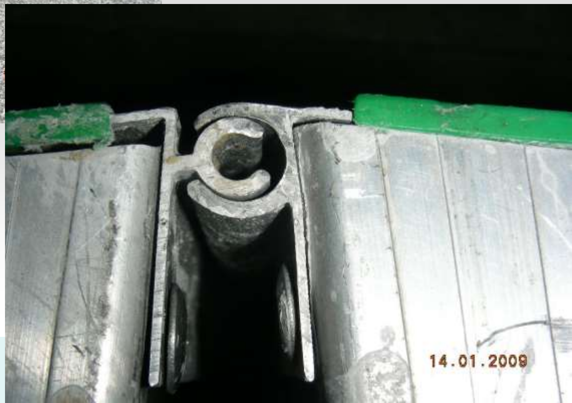
梯面接合鉚釘已遺失
